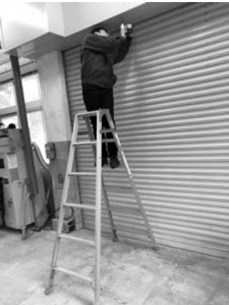
上向き作業をしない
