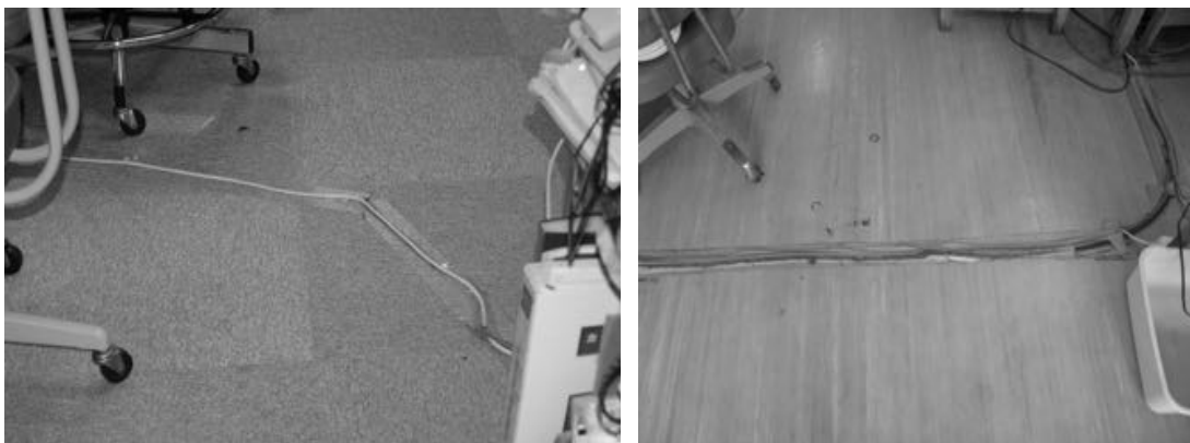
図Ⅲ. 1. 5 電源ケーブルが通路を横断
