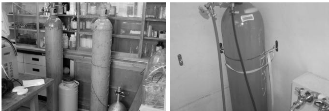
図Ⅲ. 1. 9 ガスボンベの誤固定
