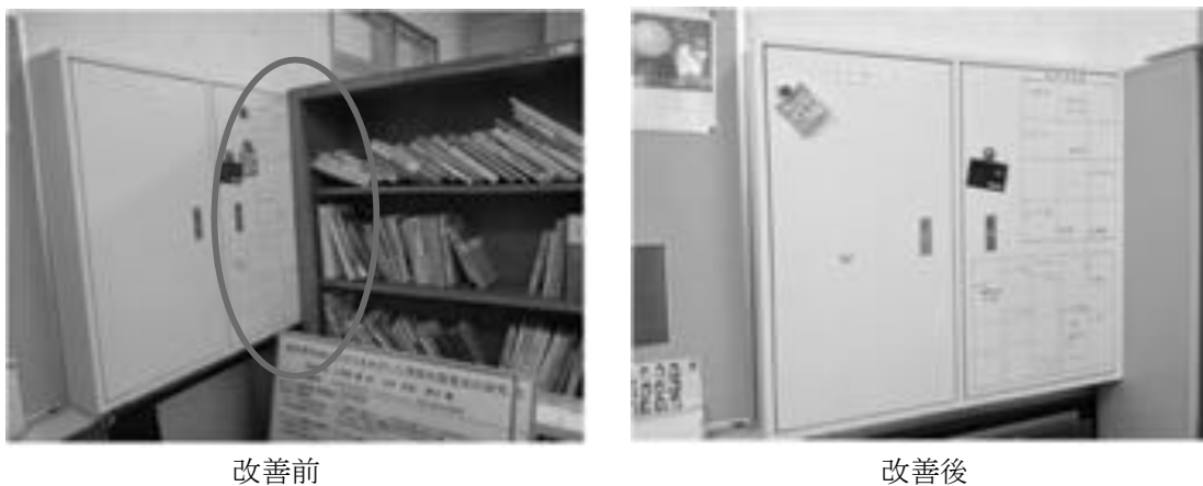
図Ⅲ. 1. 3 分電盤前の障害物
