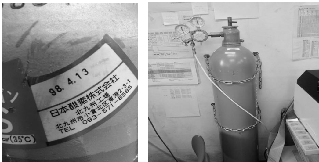
図Ⅲ. 1. 10 ガスボンベの使用期限と圧力調整器の向き
