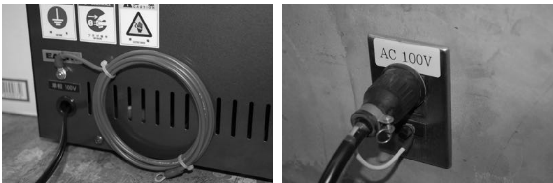
図Ⅲ. 1. 8 付属の接地線と壁用コンセントの接地端子利用
